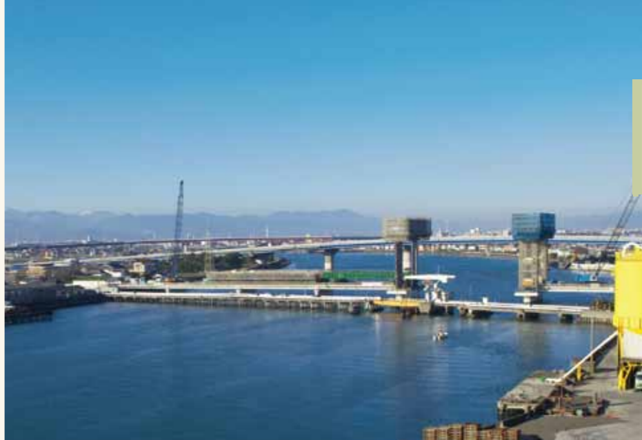
手前より加賀須野橋、新しい加賀須野橋(工事中)、新加賀須野橋、今切川橋(工事中)
