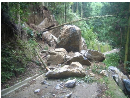
斜面崩壊の状況（平成 28 年 9 月） 飯谷町
