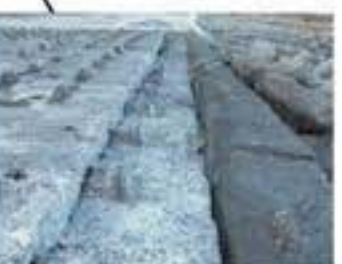
未補修 (沈下状況)
