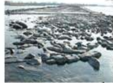
上堰① (青石の破損状況)
