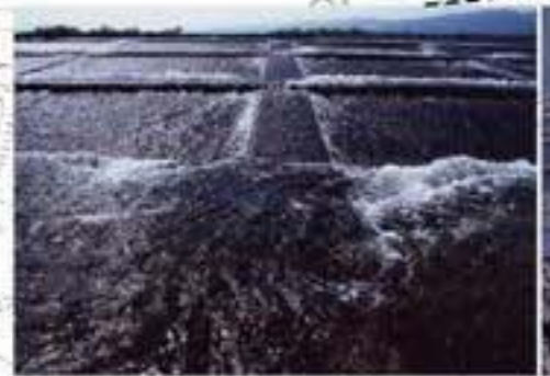
越流状況 (建設省による補修済み)
