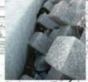
2tブロックと堰の間にできた段差
