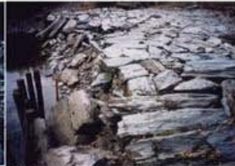
青石の破損 (根切れ状況に)
