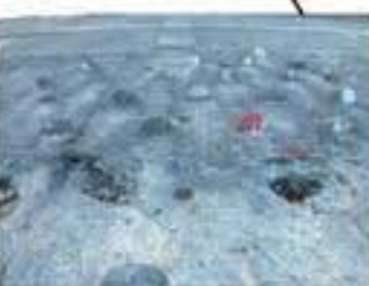
未補修 (表面のはくり状況)
