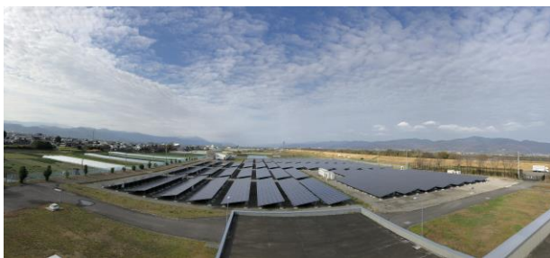
第十浄水場 大規模太陽光発電設備
