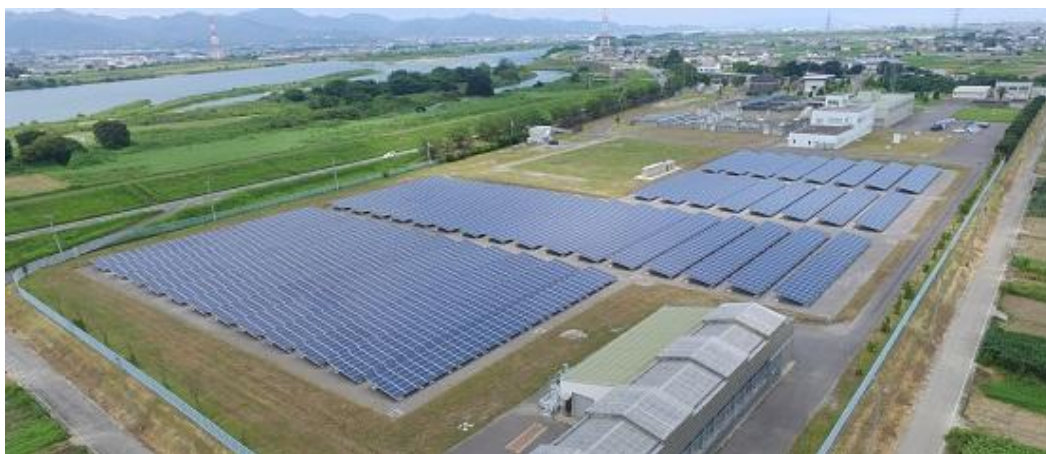
図8 太陽光発電設備（第十浄水場）
