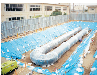
津田小学校 飲料水兼用耐震性貯水槽 (100m³)
